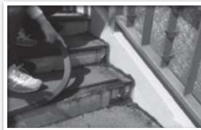
ラバーの剥がれ
